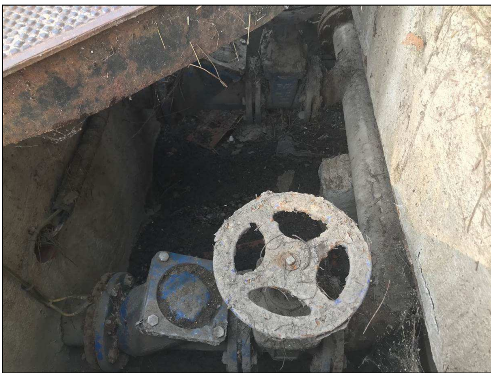
Zona de col·lectors i vàlvules
