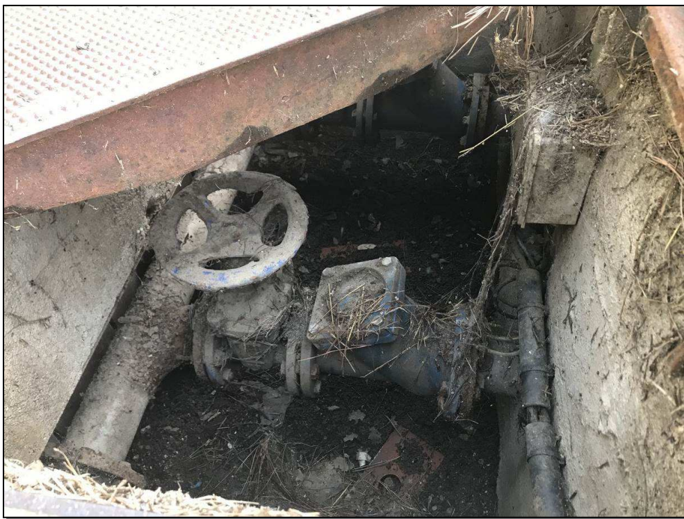
Zona de col·lectors i vàlvules
