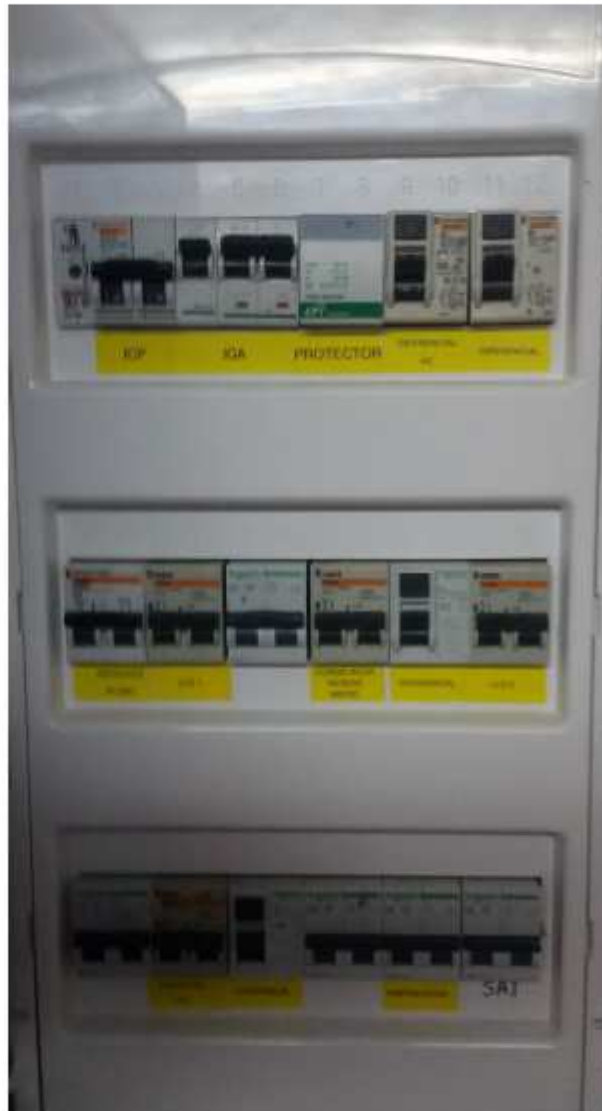
Quadre general de distribució i protecció
