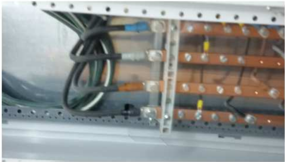
Quadre General de protecció i distribució + Subquadre SAI
