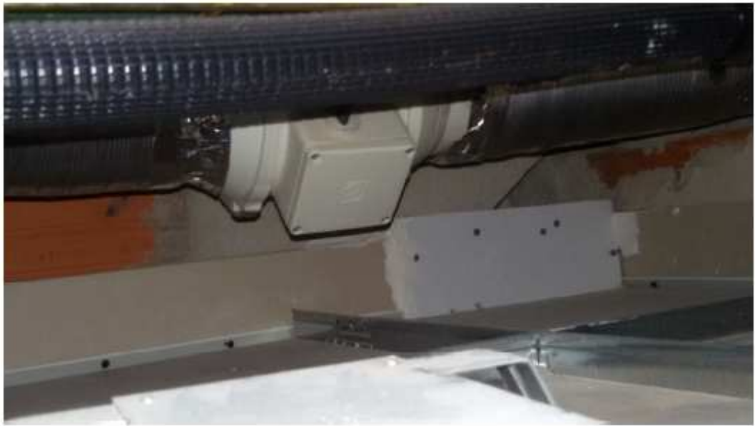
Ventilador helicocentrífug del sistema de ventilació de les zones comuns.
