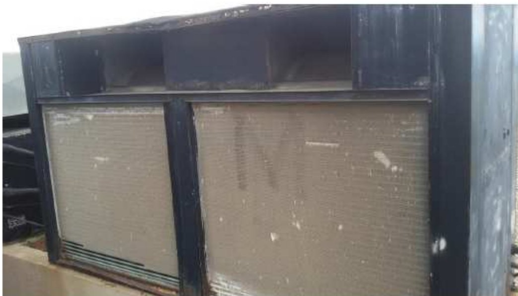
Equip de climatització CCVB-2002, tipus conductes, de la casa Hitecsa
