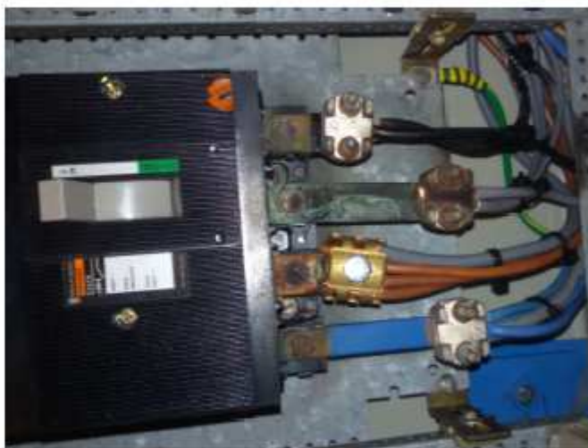
Interruptor general i mal estat del mateix
