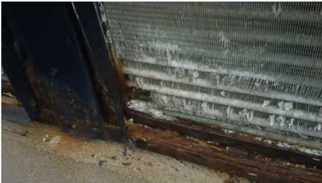
Alt deteriorament de la carcassa de la màquina exterior
