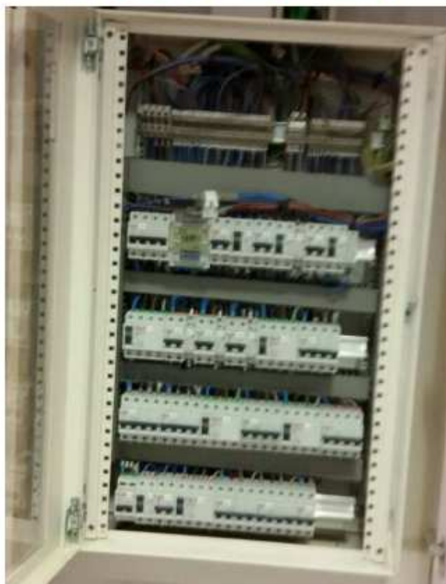
Quadre general de distribució i la protecció
