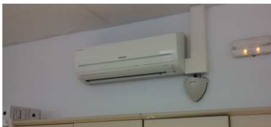
Equip de climatització tipus split de paret, de la casa Samsung
