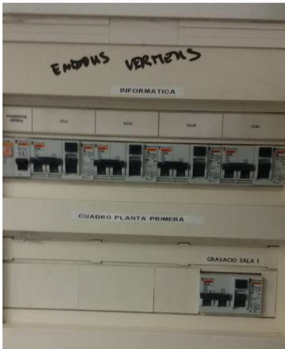
Subquadre SAI de la 1ª planta
