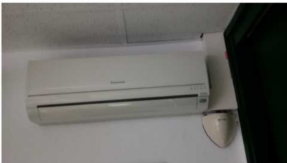
Equip de climatització tipus split de paret
