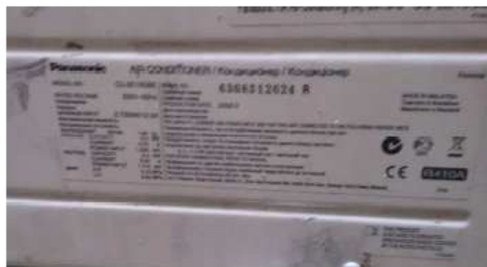
Unitat d'exterior i placa de característiques, de la casa Panasonic
