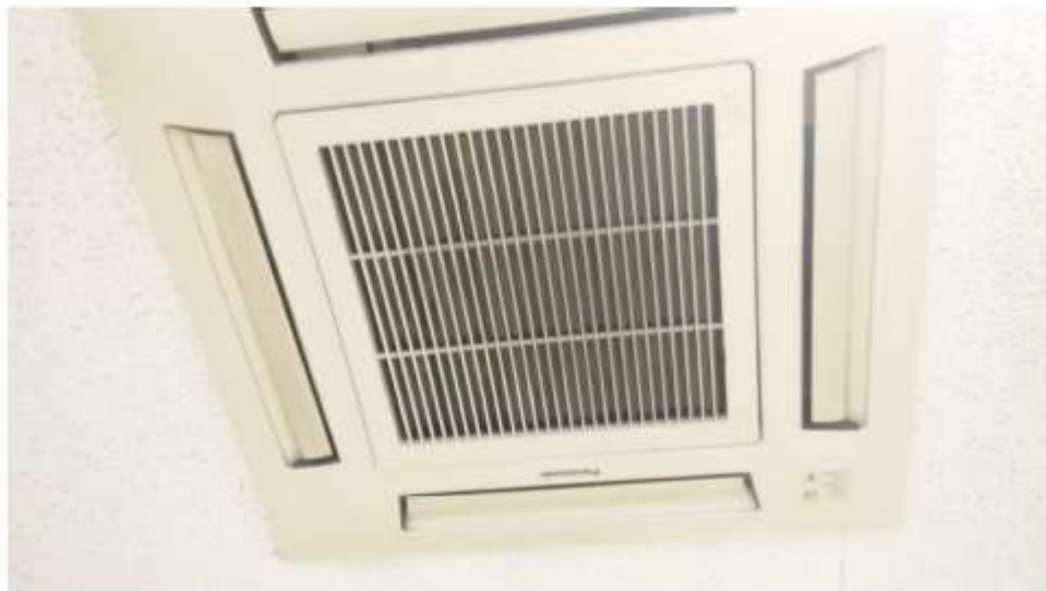
Equip de climatització tipus cassette de sostre, de la casa Panasonic
