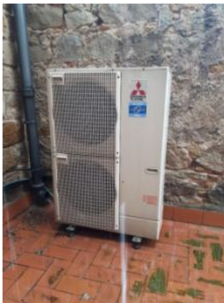
103 Condensadora sala Externs Digitalització
