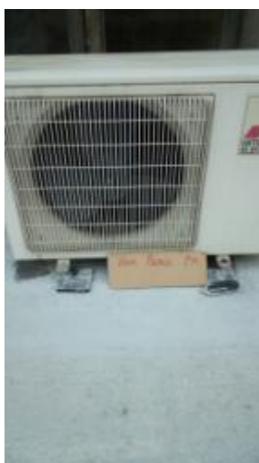
V029 P1 Condensadora Despatx Hemeroteca
