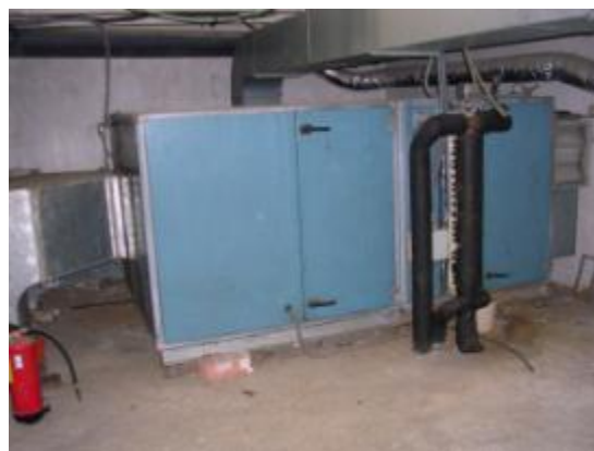
020 Evaporador amb bateria calor Magatzem Fonoteca
