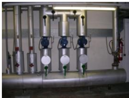
038 Bombes recirculació Bombes Calor n°1 i n°2
