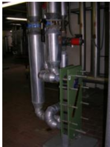
035 Intercanviador plaques i vàlvula 3 vies
