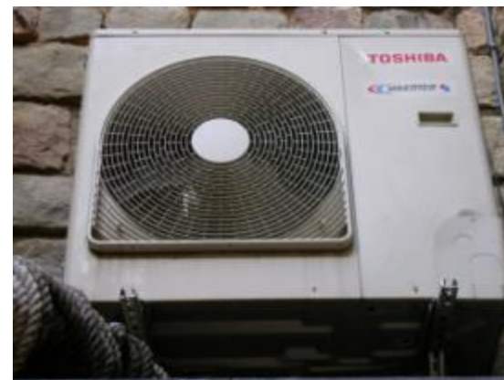
119 Condensadora Sala de La Caritat
