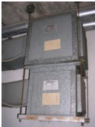
028 Ventilador sobrepressió escales
