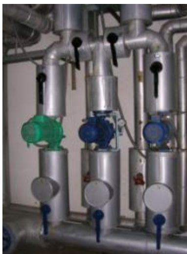
032 Bombes recirculació B1.1, B1.2 i B1.3
