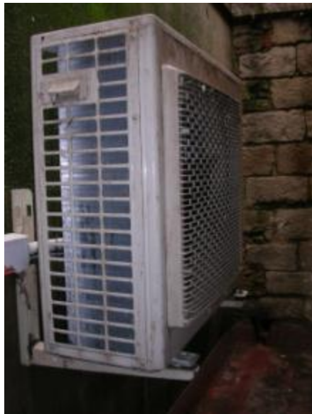
111 Condensadora Interior Sala Torres Amat
