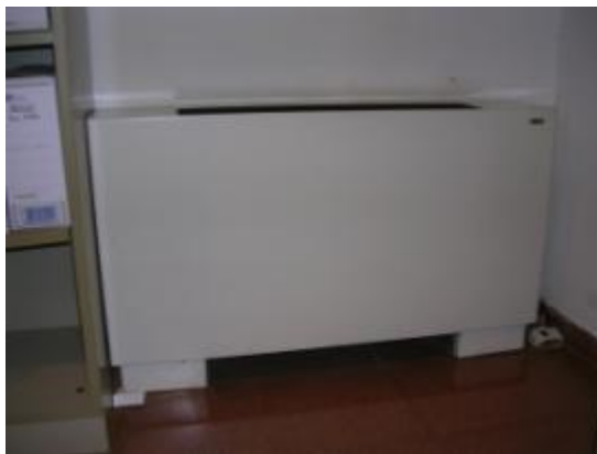
047 Fan-coils edifici oficines
