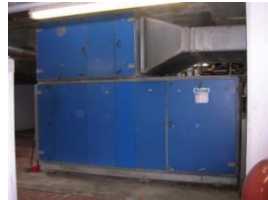
027 Climatitzador amb recuperador entàlpic CL2
