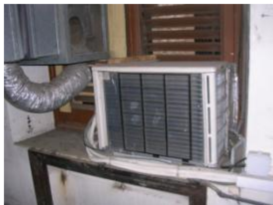
019 Condensadora fotos 017 i 018
