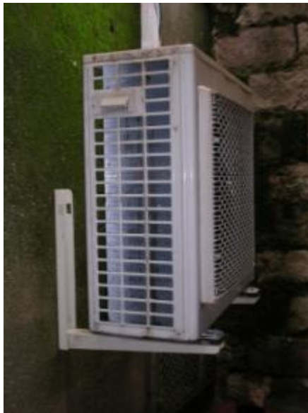
112 Condensadora Accés Sala Torres Amat
