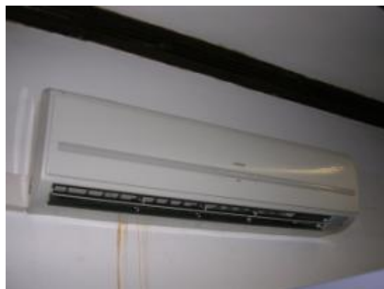
120 Sala Servidors ATI costat dret
