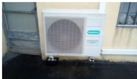
V020 Condensadora P2 Sala Gran Restauració
