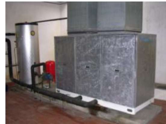
021 Bomba de calor magatzem fonoteca
