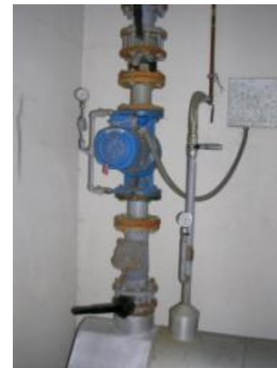
036 Bomba intercanviador i ompliment Bombes calor
