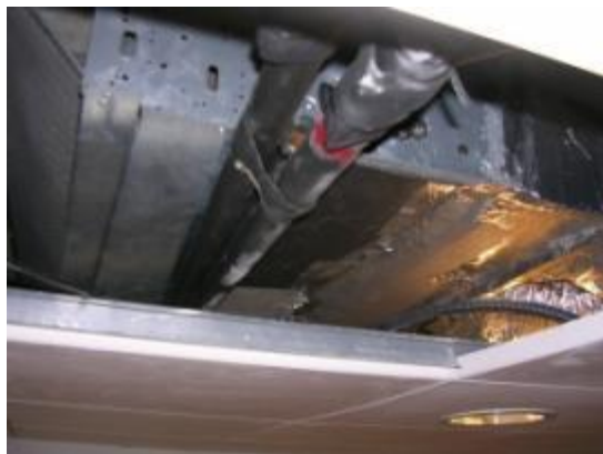
049 Fan-coil falç sostre zona treball Direcció
