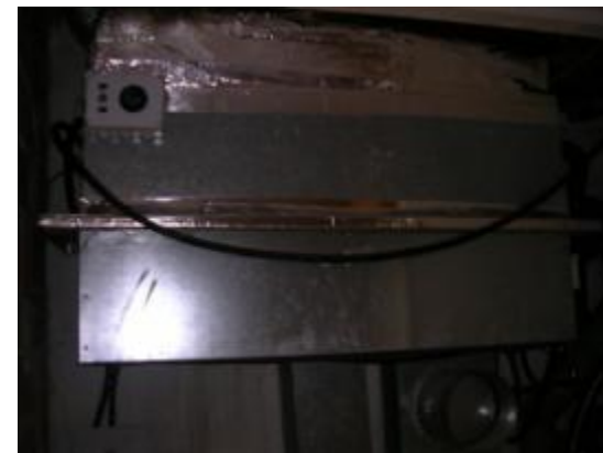
048 Fan-coils zones treball edifici oficines
