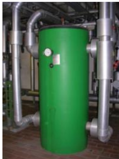
034 Dipòsit mescla aigua freda dipòsits
