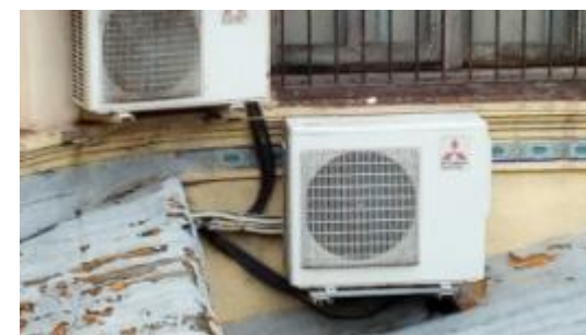
V006 Condensadora PB Dipòsit Legal
