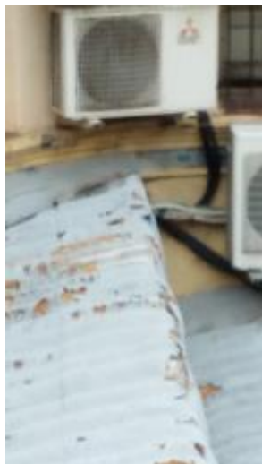
V007 Condensadora PB Material Menor
