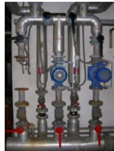
030 Bombes recirculació B2.1, B2.2 i B2.3
