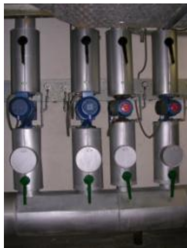
037 Bombes recirculació oficines i S. Lect.
