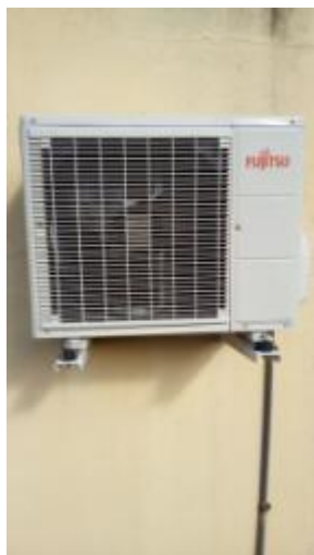
V034 P2 Condensadora Despatx Restauració
