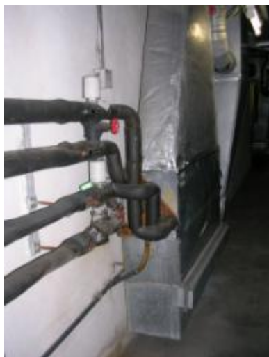
043 Fan-coils dipòsits llibres
