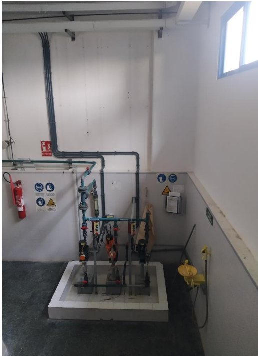
Instal·lació de dosificació a conservar. Obertura d'accés en la paret de la dreta, sota la finestra i fins al sòcol.
