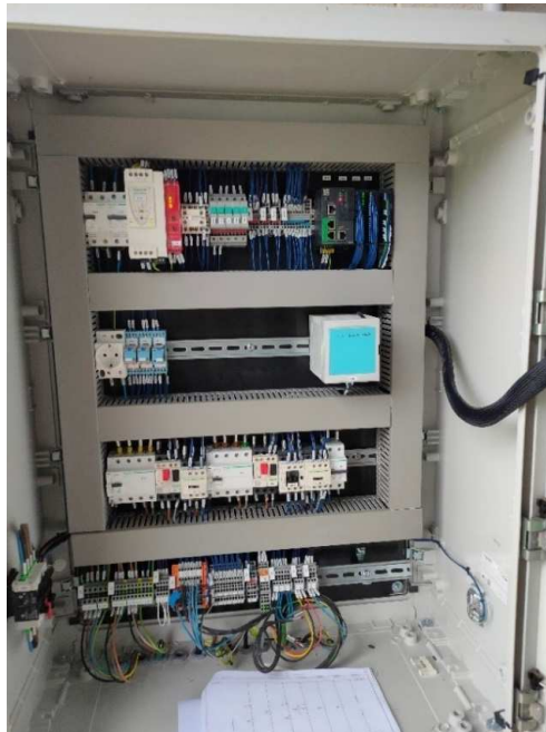
Vista interior armari elèctric sitja
