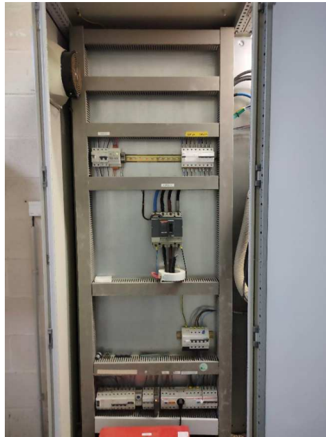
Vista interior primer mòdul armari elèctric CCM
