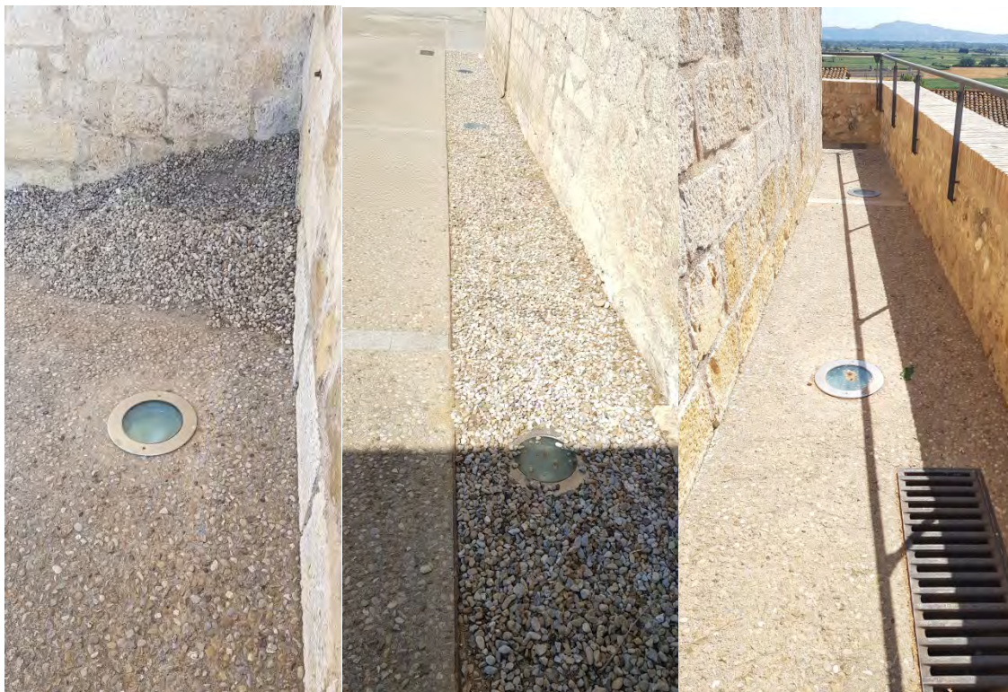
Imatge 2. Enllumenat existent
