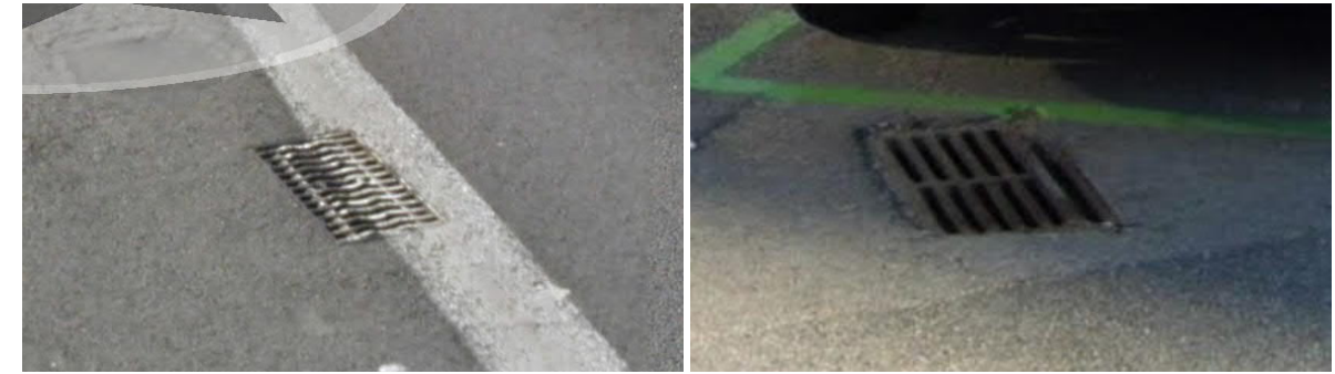
Esquerra – embornal existent a c/. Numància en el carril bus de pujada, dreta – embornal situat al c/. Numància a la banda Besós.
