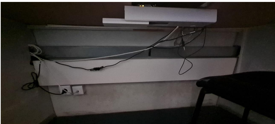
Imatge 5. Canalitzacions a les cabines d'interpretació
