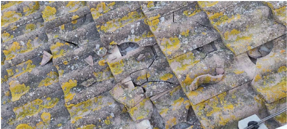
Presència de trossos de te teules en la coberta
