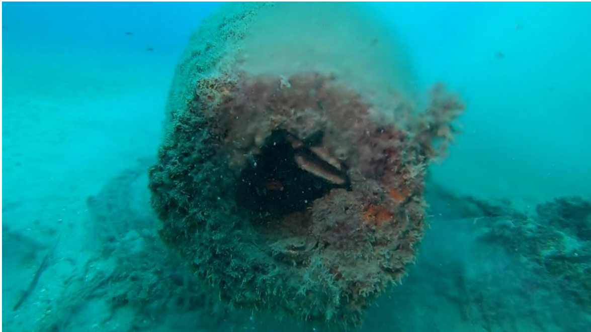
Sortida final amb efluent – xarxa adherida – Ramal Central
