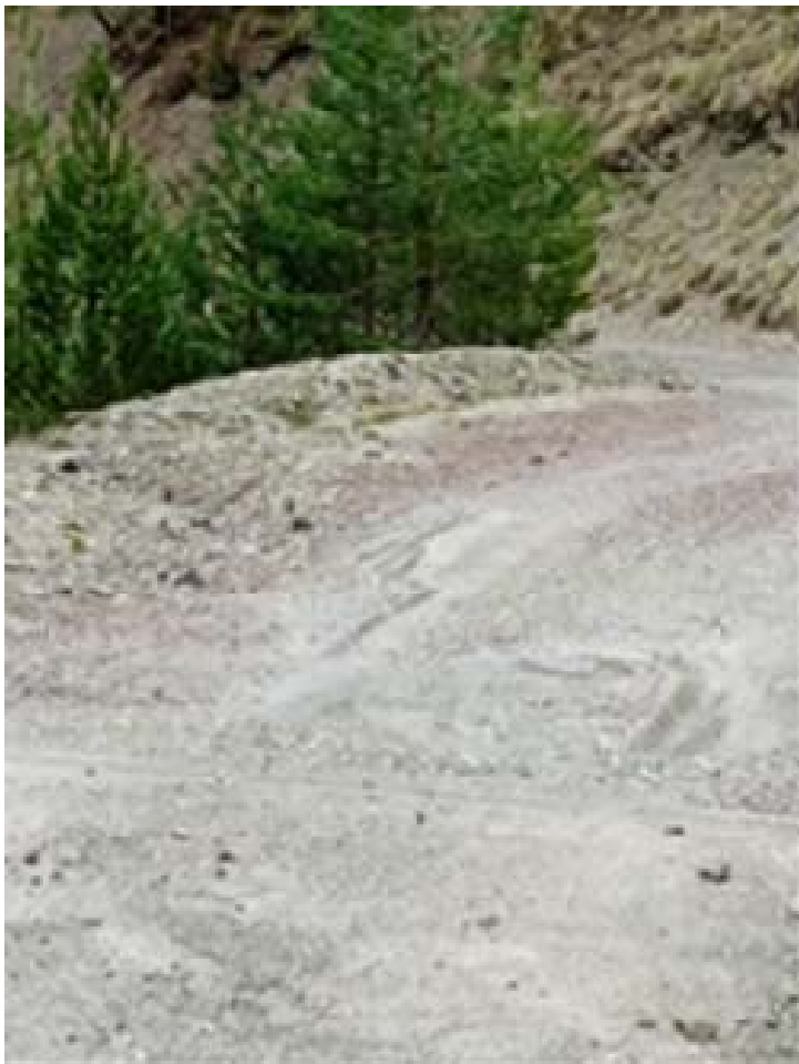
Imatge del problema puntual d'acumulació d'aigua al paratge anomenat el Terrers que convé solucionar amb la construcció d'un drenatge. X:392352,0 Y: 4678792,0
