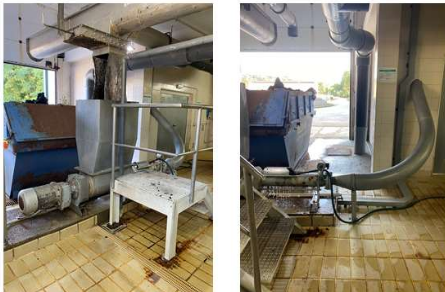
Figura 2.1. Bomba de fangs i estat del terra de la sala.
